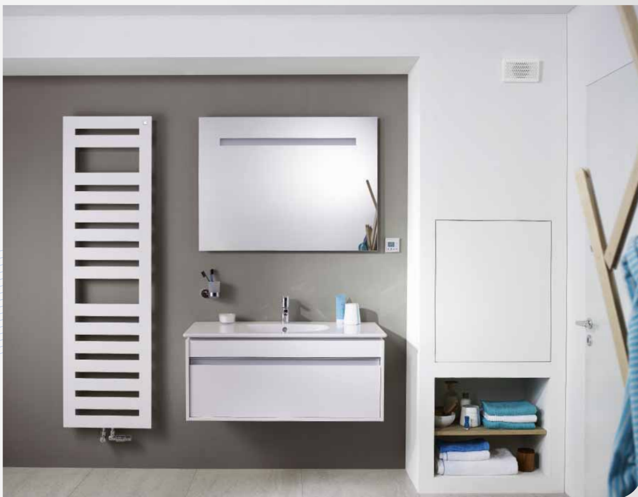
Instalace v koupelně - zakrytá
